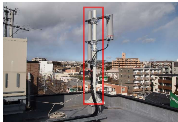
アンテナ支持柱
