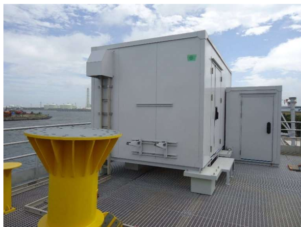
重塩害対応 機器收容局舎
