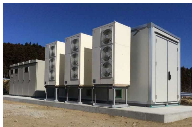
HPC設備 機器収容局舎
