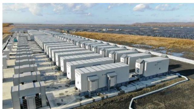
PVインバーター収容局舎
