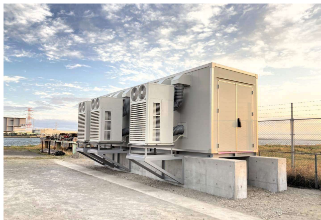
風力発電 機器收容局舎
