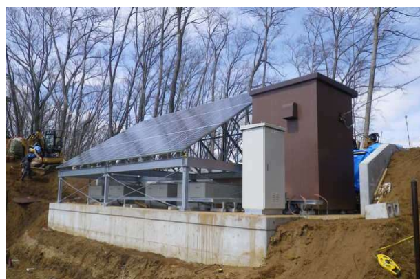
独立電源設備 機器收容局舎
