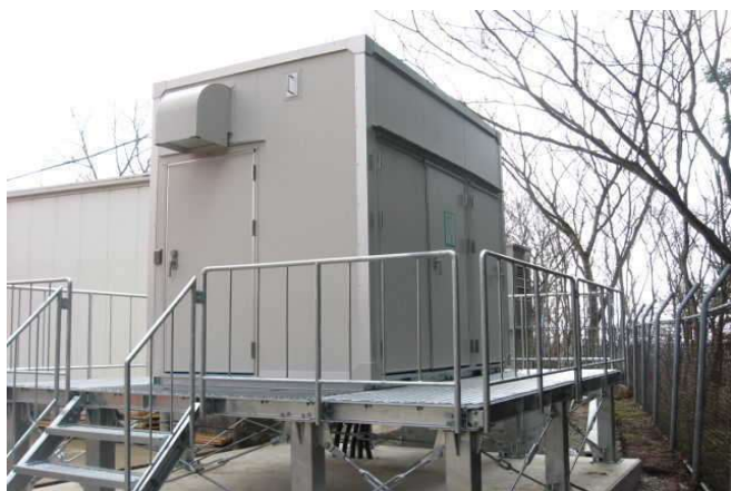
消防防災無線機 機器収容局舎
