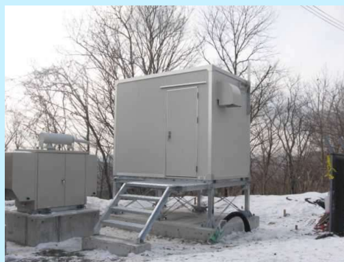
鉄骨架台 機器収容局舎
