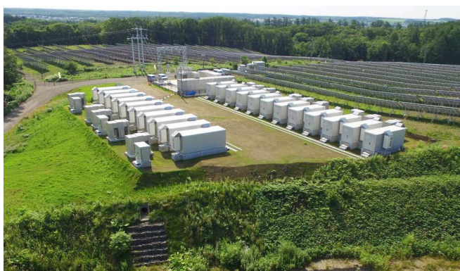
PVインバーター収容局舎
