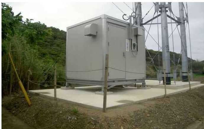
水位観測 機器收容局舎
