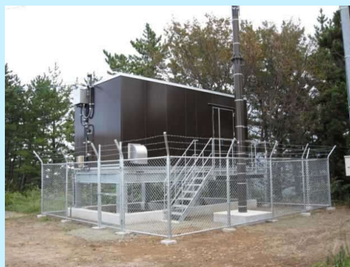
環境色対応 機器収容局舎
