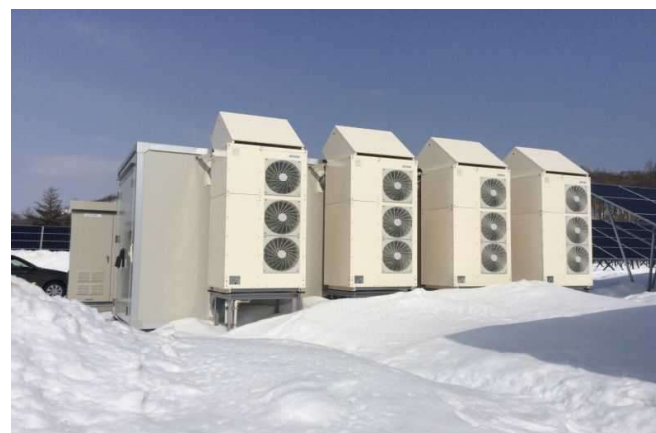
HPC設備 機器収容局舎
