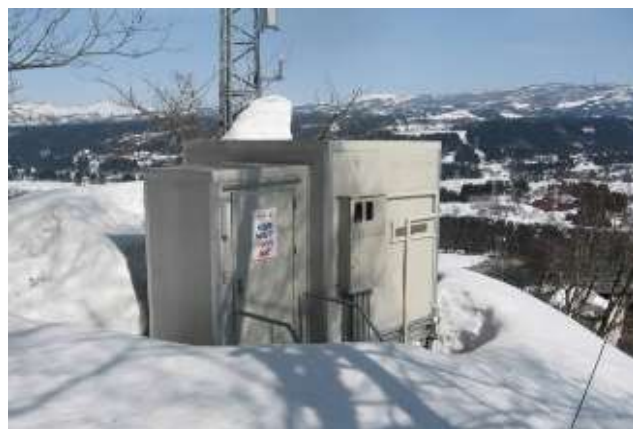
放送通信設備 機器收容局舎
