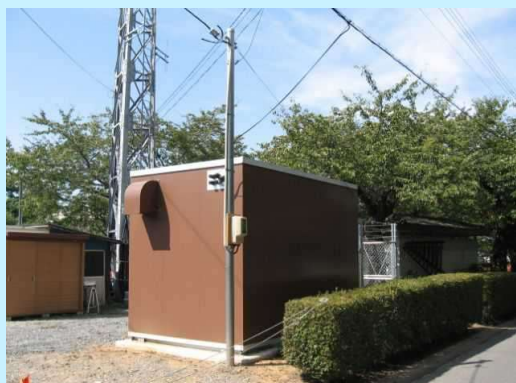
環境色対応 機器収容局舎
