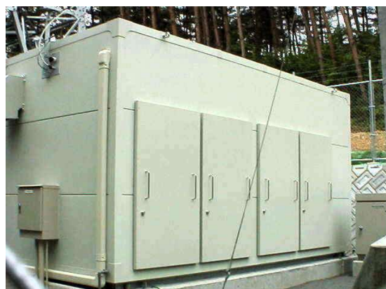
多扉 機器收容局舎
