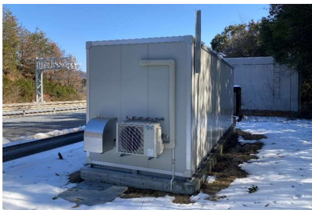
自動車道ETC設備 機器收容局舎
