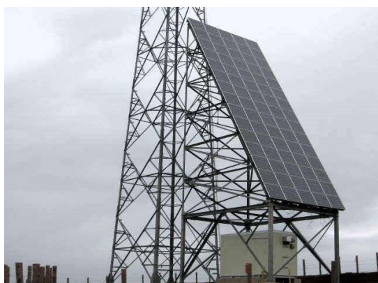
自立電源設備 機器收容局舎
