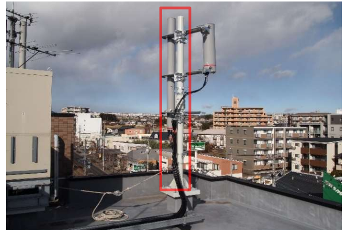
アンテナ支持柱
