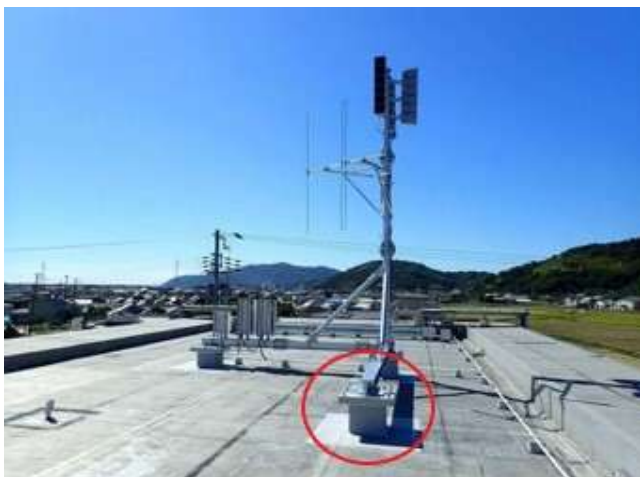
防災無線設備用架台
