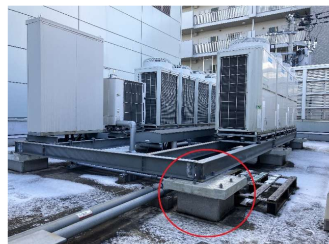
空調室外機用架台
