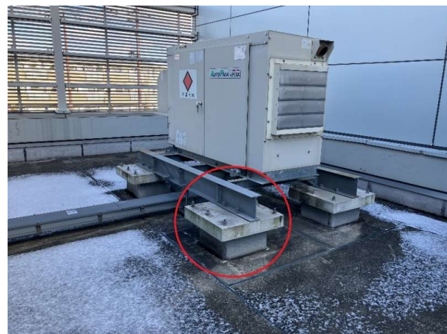
非常用発電機用架台
