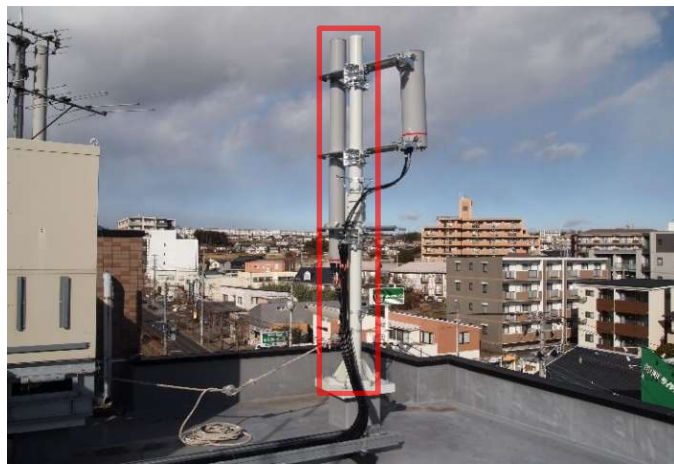
アンテナ支持柱
