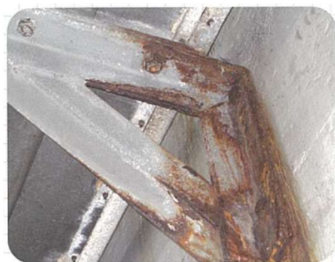
亜鉛メッキ鋼材のサビ状況
