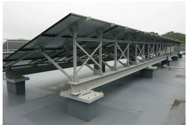
宮城県_屋上 (CSフレーム+ベース キューブ)
