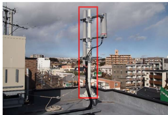
アンテナ支持柱
